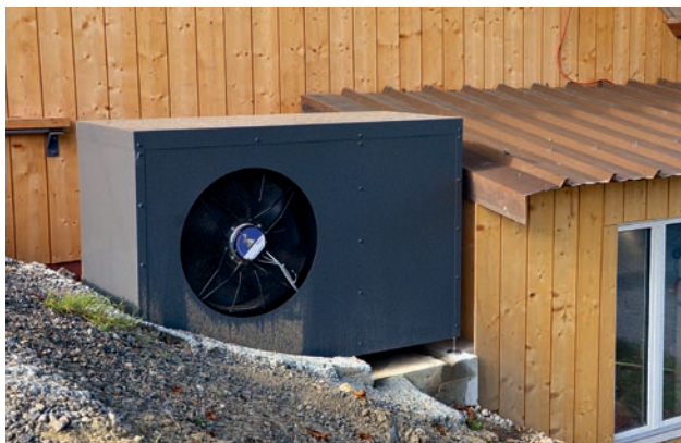
Die Wärmepumpe ist ausserhalb des Kälbermaststalls platziert und entzieht dort der Umgebungsluft Energie.
