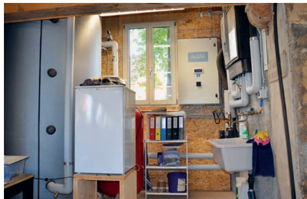
Im Wärmespeicher links wird das durch die Wärmepumpe erwärmte Heizwasser gespeichert, rechts befindet sich die Frischwasserstation.
